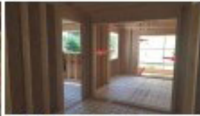
트리머(질)스태드 갯수부족 트리머 하단 조이스트 보강(체크안됨)
